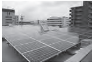
屋上全面の太陽光パネルと光ダクトの採光口
